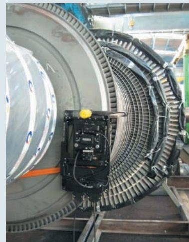
Пример крепления прибора на роторе турбины
